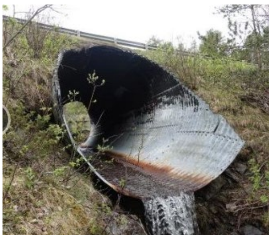
Ved profil 2800: Hyllebekken bru, eksisterende rør for Hyllebekken vil bli byttet ut med nytt rør/konstruksjon. Bekken er ikke fiskeførende.
