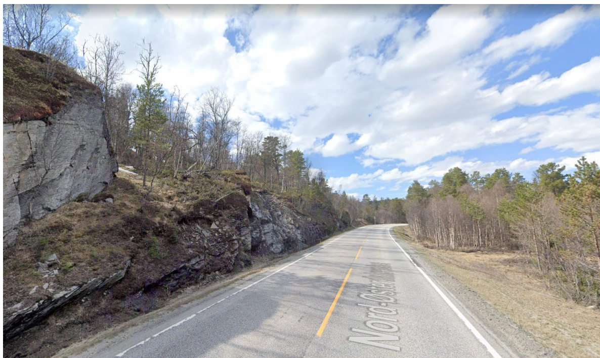
Foto: Det er flere lave fjellskjæringer på vestsiden av vegen, tett inntil vegbana. Kilde: 9 Nord-Østerdalsveien - Google Maps
