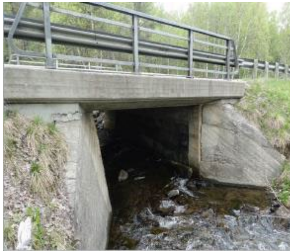
Ved profil 5100: Fuglåsbecken bru vil bli ertattet av en ny bru. Bekken er ikke fiskeførende.
