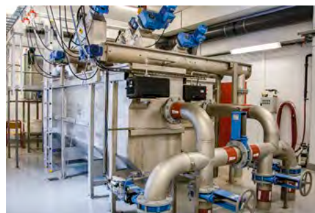
FØRSTE STEG: Her starter renseprosessen. Kloakken kommer inn på baksiden av denne installasjonen. Grove partikler som har kommet gjennom pumpene skilles fra avløpsvannet
