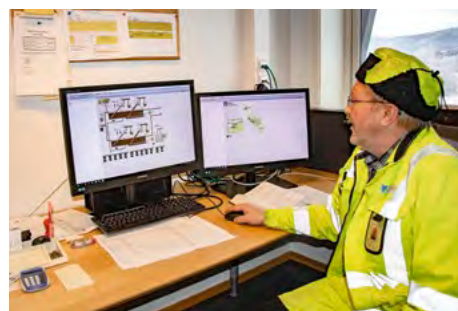
OVERVÅKING: Både renseanlegget og vannverkene i kommunen overvåkes 24 timer i døgnet. PC-er og elektroniske installasjoner har gjort jobben enklere enn tidligere. Her sjekker John Kvernbeekeng. På høyre monitor vises en oversikt over kommunens vannverk og renseanlegg for vannleveranser
